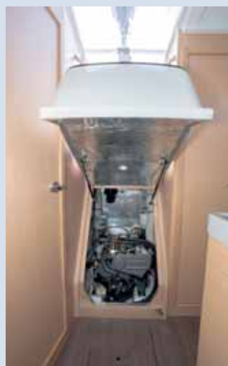
Přístup k motoru pod schody je tradičně velmi dobrý.
