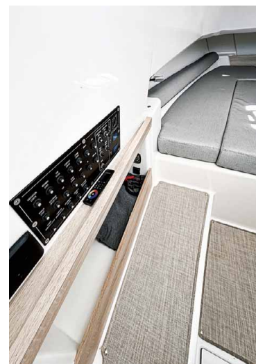
Jističe jsou umístěny v kajutě na levoboku.
