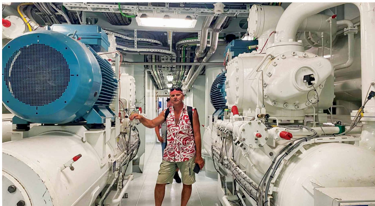
Chlazení sladké vody probíhá právě v těchto obrovských výměnících.
